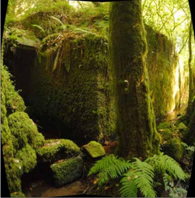
Vista do zócolo da central, á esquerda a saída da canle de descarga.
