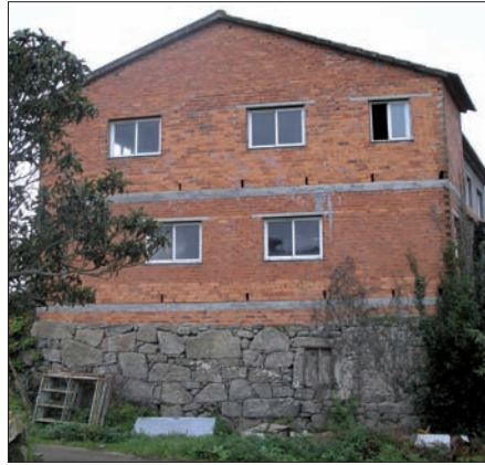
Pardiñeiro medieval do Outeiro (arriba). O mesmo aproveitado para unha obra ilegal (abaixo)
